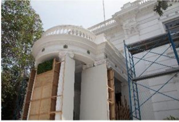
Figura 120. Mal uso de la fachada de la Palacete Sousa
