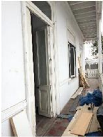
Figura 119. Deterioro de pasillos de la Palacete Sousa
